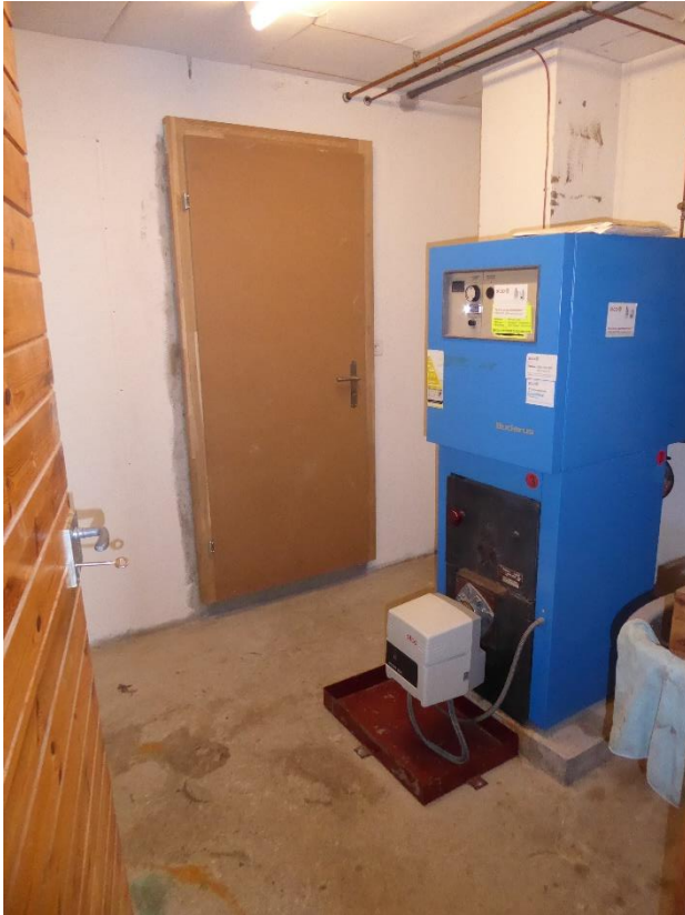
Chaudière à mazout
