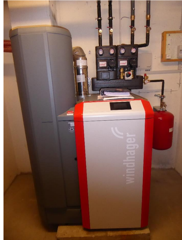
Chaudière à pellets
